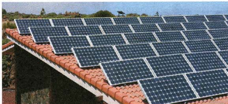
Installation héliothermique en toiture
